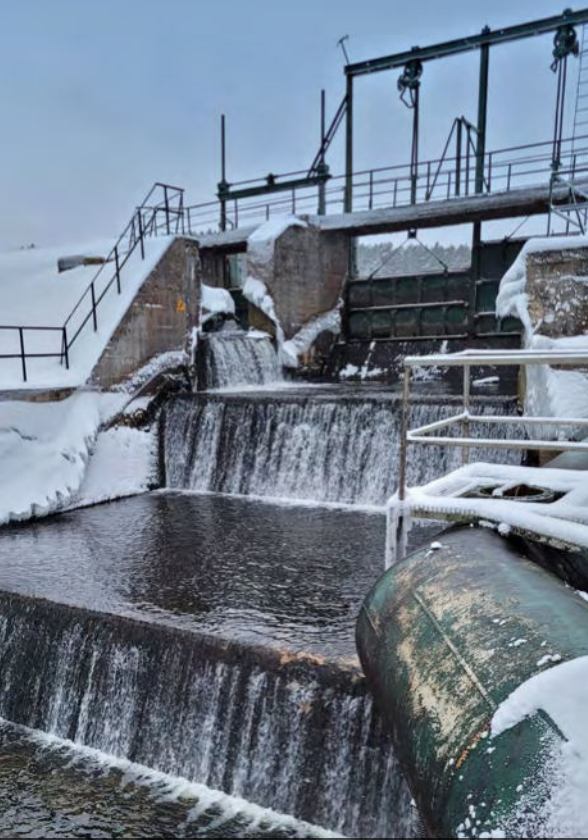
Wasserkraftwerk bei Intersurgical in Litauen
